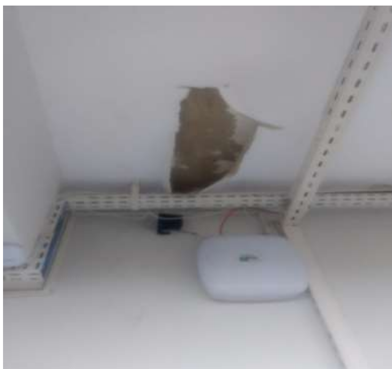
AVALIAÇÃO EM PAREDE COM PINTURA DESCASCADA
