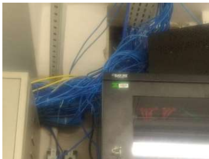
LIGAÇÃO ELÉTRICA IMPROVISADA E APARENTE UMIDADE NA LAJE DEVIDO A PROBELMAS HIDRÁULICOS E INFILTRAÇÃO
