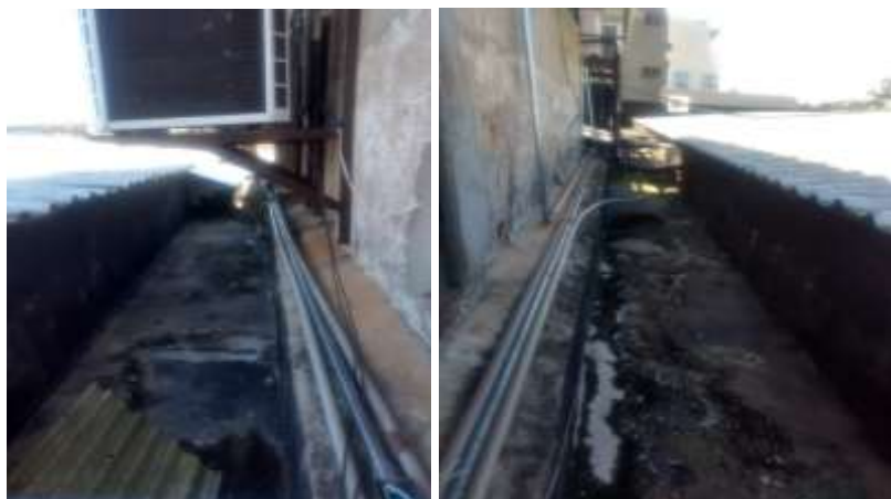
CALHA SEM IMPERMEABILIZAÇÃO
