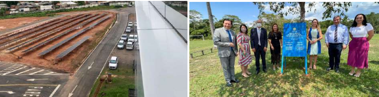
usina de energia solar... Instalações da energia solar na Cidade da Justiça de Rio Branco e em Cruzeiro do Sul
