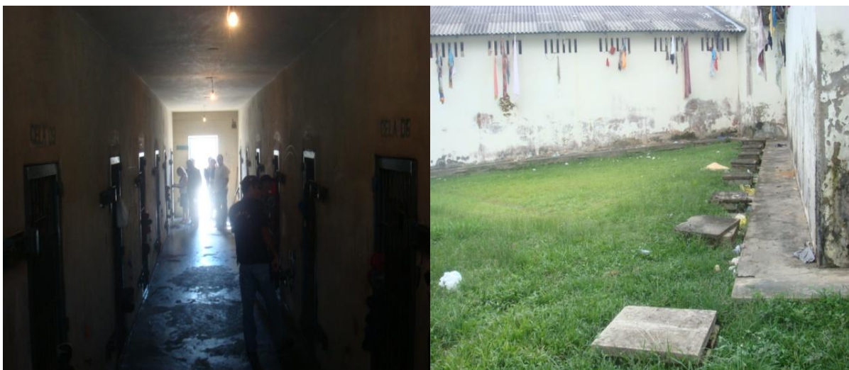
Escuridão e insuficiência de ventilação nos corredores, sujeira e esgoto a céu aberto do lado externo.
