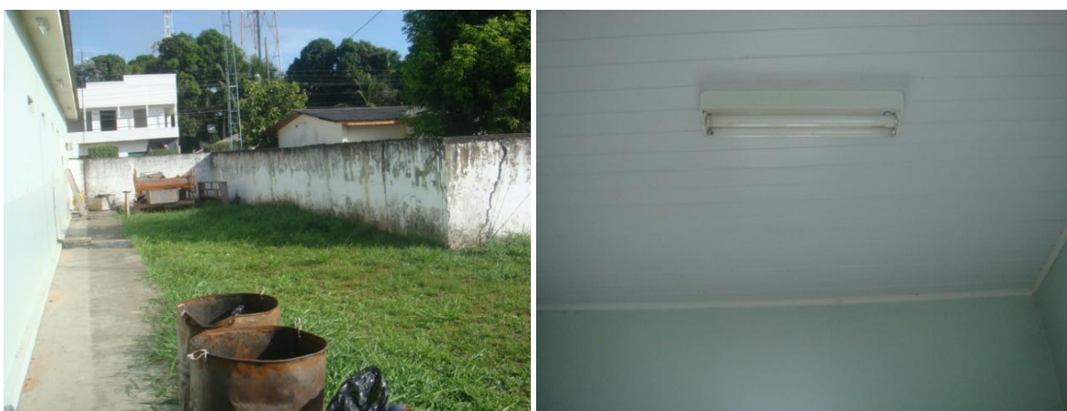
Muro baixo e forro impróprio (PVC) – vulnerabilidade do local.
