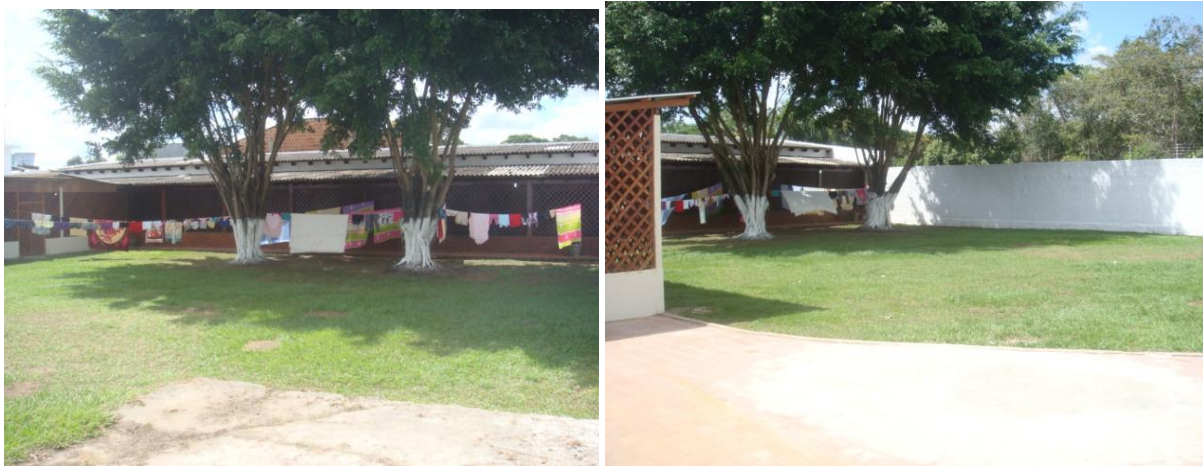
Pátio de banho de sol – área externa protegida com treliças de madeira e muro baixo: vulnerabilidade.
