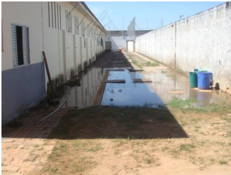
Esgoto a céu aberto na UP Francisco D'Oliveira Conde
